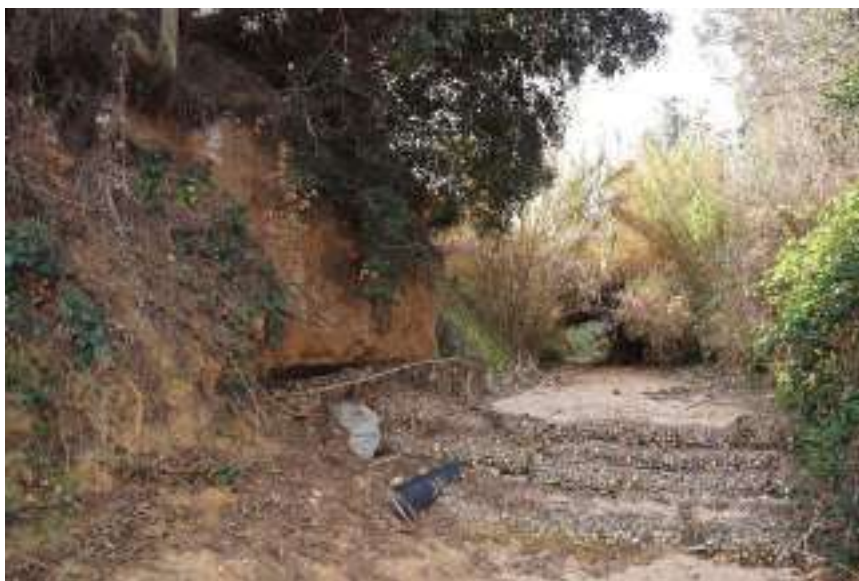
Fotografia 4: Riera de Vallromanes, prop de la carretera de Can Xec, on es nota l'encaixonament del llit, el soccavament i verticalitat dels marges, morfologies afavorides a l'alta erosionabilitat dels materials del subsol d'aquesta àrea.
