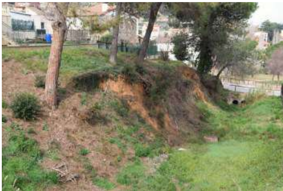
Fotografia 11: Vista del marge dret del torrent de Can Coll, entre els carrers de Roure i de Can Coll, on es pot observar la formació quaternària de fins predominant i on es poden originar algunes esllavissades afavorides per l'escorrentia superficial.
