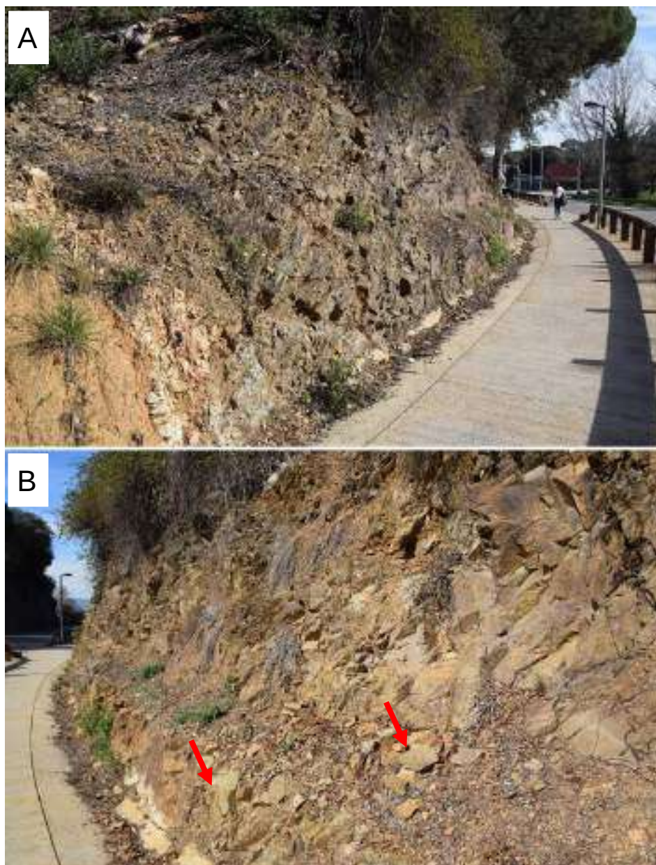
Fotografia 12: (A) Talús situat en marge nord de la BV-5001 i junt al camí de vianants que descorre entre Montornès del Vallès i Montmeló, (B) on es poden observar alguns blocs caiguts de fins alguns decímetres.
