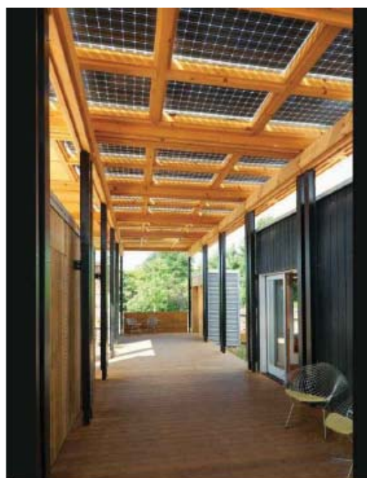
PASSADÍS EXTERIOR AMB COBERTA FOTOVOLTAICA
