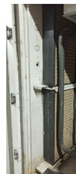
Filtres bruts de la deshumectadora
