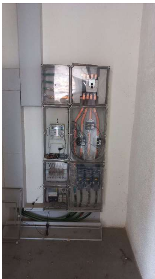
Imatge 4. Detall escomesa elèctrica
