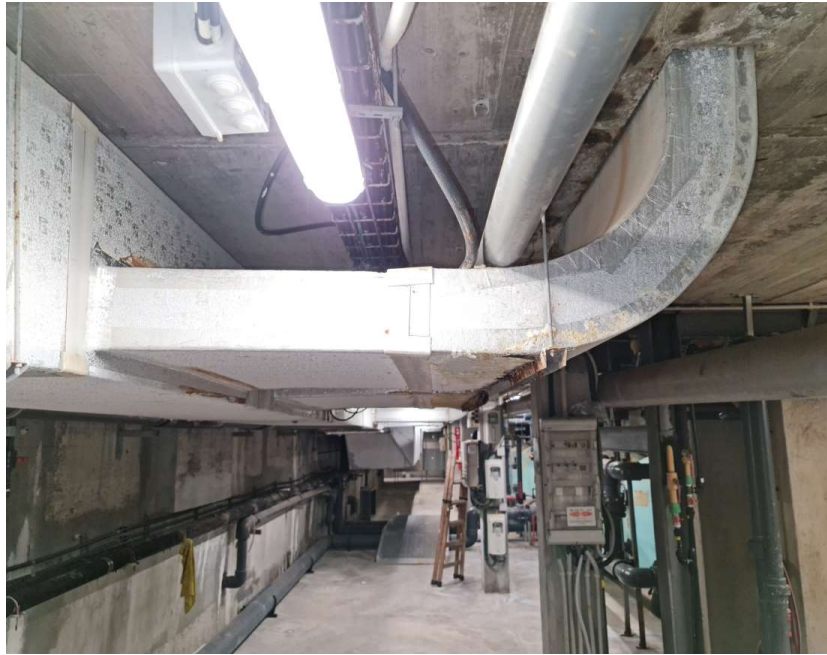
Imatge 4. Passos de forjat existents per a connexió amb elements de difusió retorn d'aire de planta baixa.
