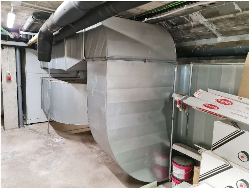
Imatge 1. Deshumectadora existent i connexions de les xarxes d'impulsió i retorn
