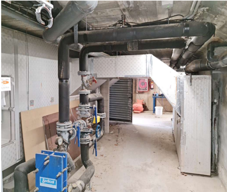
Imatge 2. Xarxa de retorn existent amb Piralu
