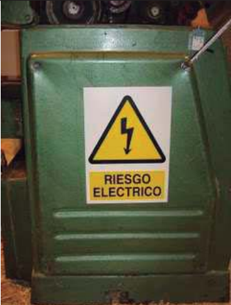
Foto 06: Tots els riscos elèctrics estaran degudament senyalitzats
