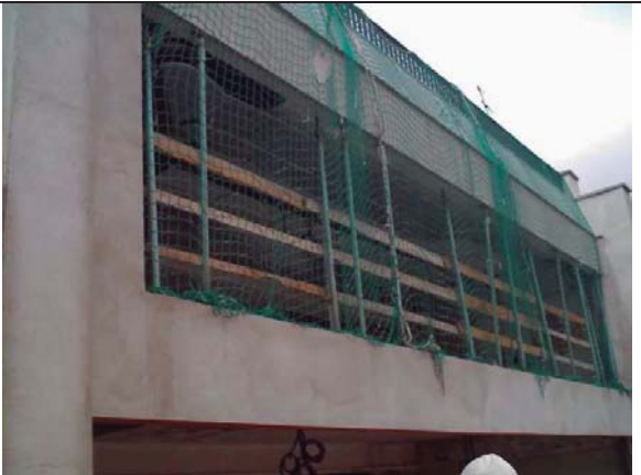
Foto 02: Totes les obertures de façana hauran d'estar protegides en tota l'alçada.
