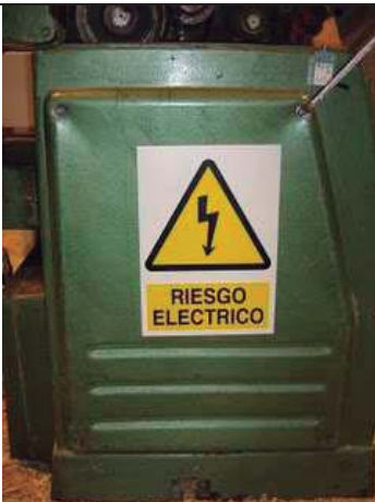
Foto 03: Tots els riscos elèctrics estaran degudament senyalitzats
