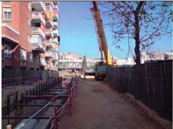
Foto 01: En el cas de no existir espai al perímetre d'excavació es col·locarà barana de protecció
