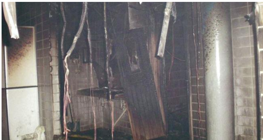
Danys materials a la sauna i els vestidors de la piscina coberta
